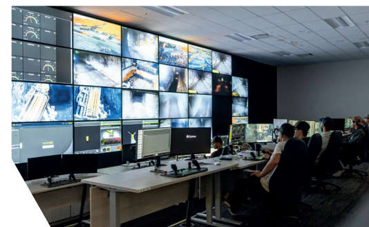
Notre nouvelle salle de contrôle du complexe opérationnel. Elle comptera éventuellement 96 contrôleurs.
