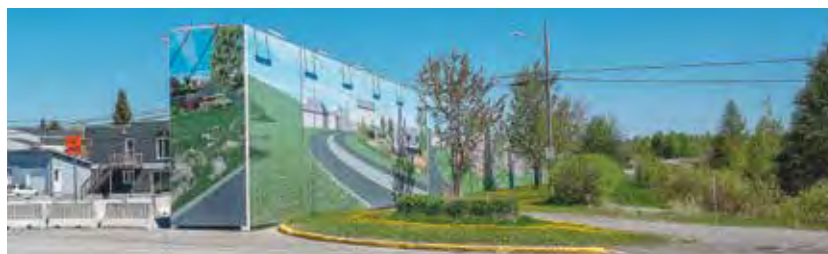
APRÈS LA MISE EN PLACE DE L'ÉCRAN ACOUSTIQUE TEMPORAIRE
